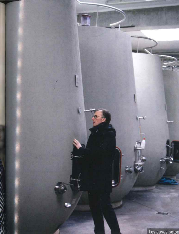
Les cuves béton.
